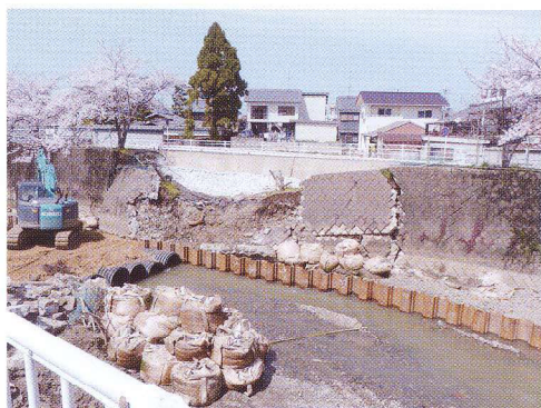
▲大水でくずれた堤防
