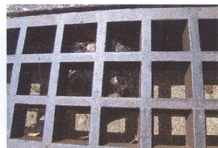
写真-6 側溝のフタ
