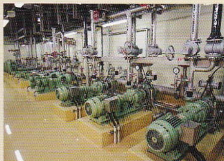
▲地下ポンプ室
