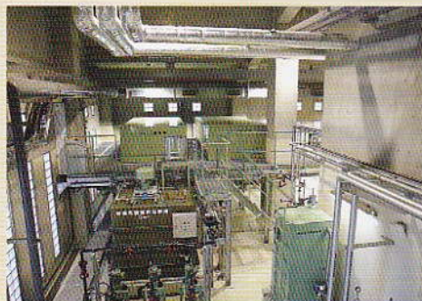
▲前処理・脱水機室
