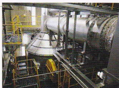
▲污泥处理设备室
