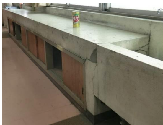
図 1-2：傷んだ教室内の流し・戸棚の例
