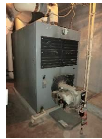
熱源設備 (ボイラー)
