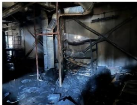
損傷したリサイクルセンターの内部
