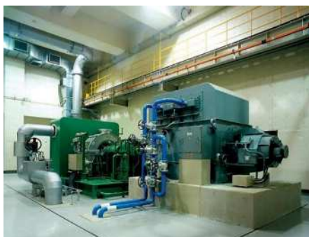
図20 クリーンセンターかしはら 蒸気タービンと発電機
