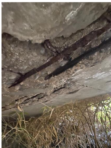
断面欠損の例①
