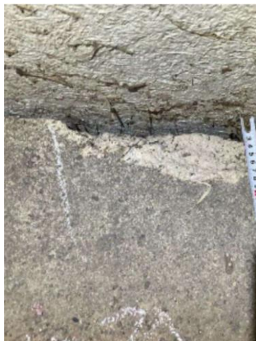
断面欠損の例②
