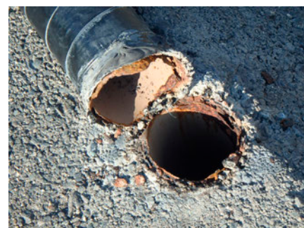
根元が錆びて倒壊した鉄柱
